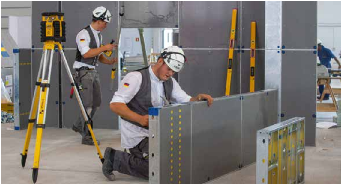
Die bayerischen Bronzemedailengewinner im Wettbewerb der Betonbauer, Julian Kiesel (l.) und Niklas Berroth (r.) während des Wettbewerbs der WorldSkills 2019.
